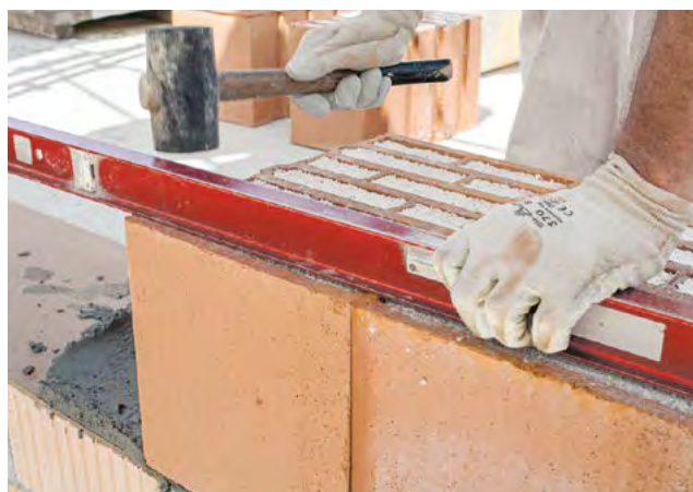
6. Commencer la première couche « mouillé sur mouillé » ou après séchage avec le mortier en couche mince
